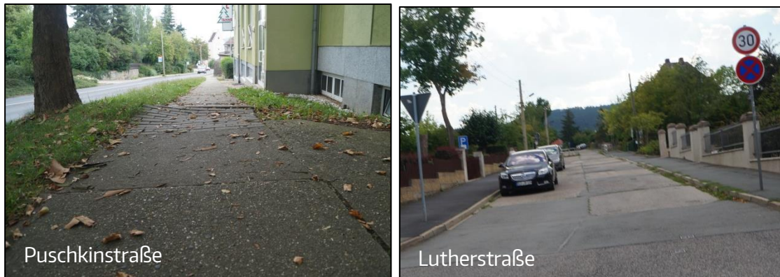
Abb. 19 Infrastruktur im Bestand - Oberflächendefizite
